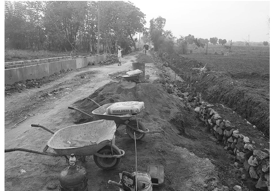
SIDAK : Komisi III saat memantau pelaksanaan proyek pembangunan milik Dinas Pekerjaan Umum (DPU).
